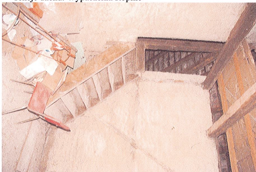
- Zdjęcie nr 14 : Korozja biologiczna węzła. Słup i miecz do wymiany (przy schodach wyrównawczych różnych poziomów podłogi strychowej)
