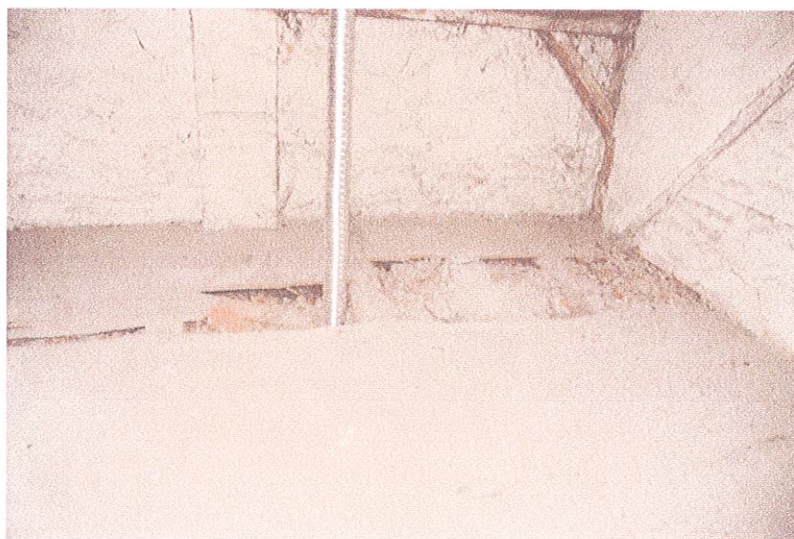
- Zdjęcie nr 12 : rozpięte kanały do wentylacji grawitacyjnej
