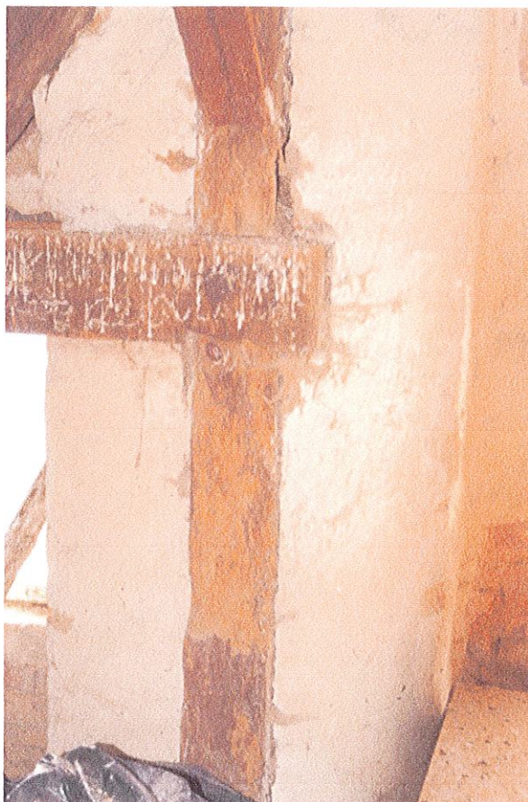
- Zdjęcie nr 8 : Korozja biologiczna jętki. Jętka do wzmocnienia.
