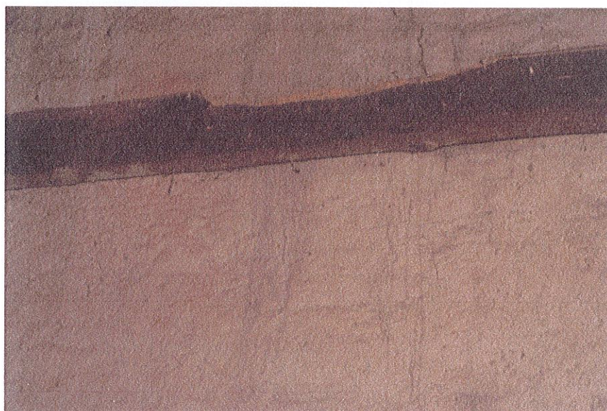
- Zdjęcie nr 9 : Korozja biologiczna węzła. Słup, miecz, kleszcz do wymiany.
