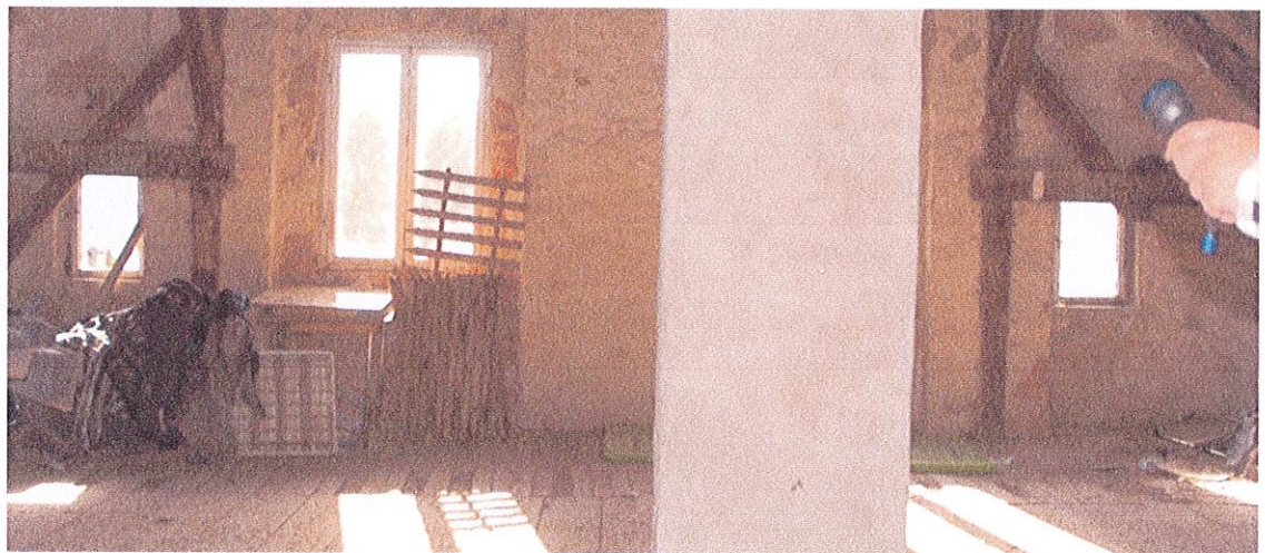
- Zdjęcie nr 11 : Uszkodzona podłoga strychu z desek do uzupełnienia.
