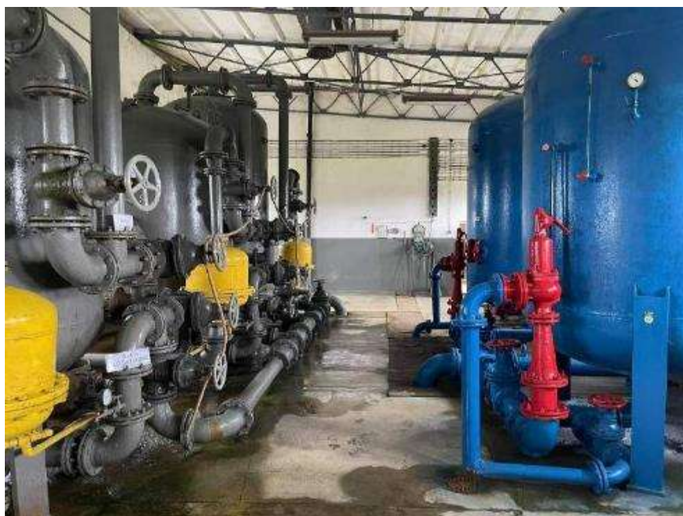
Rysunek 64. Zdjęcie wewnątrz budynku stacji uzdatniania wody w Przebędowie.
