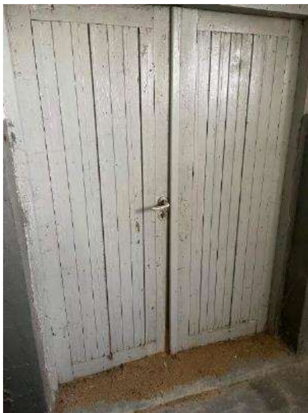
Rysunek 74. Zdjęcie drzwi do wymiany wewnątrz w budynku stacji uzdatniania wody w Przebędowie.
