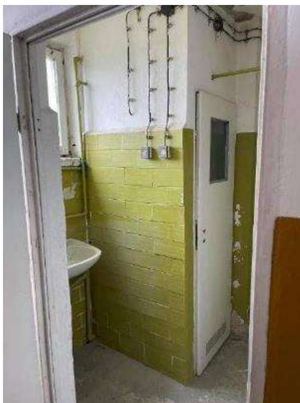
Rysunek 68. Zdjęcie drzwi do wymiany i pomieszczeń do remontu wewnątrz w budynku stacji uzdatniania wody w Przebędowie.
