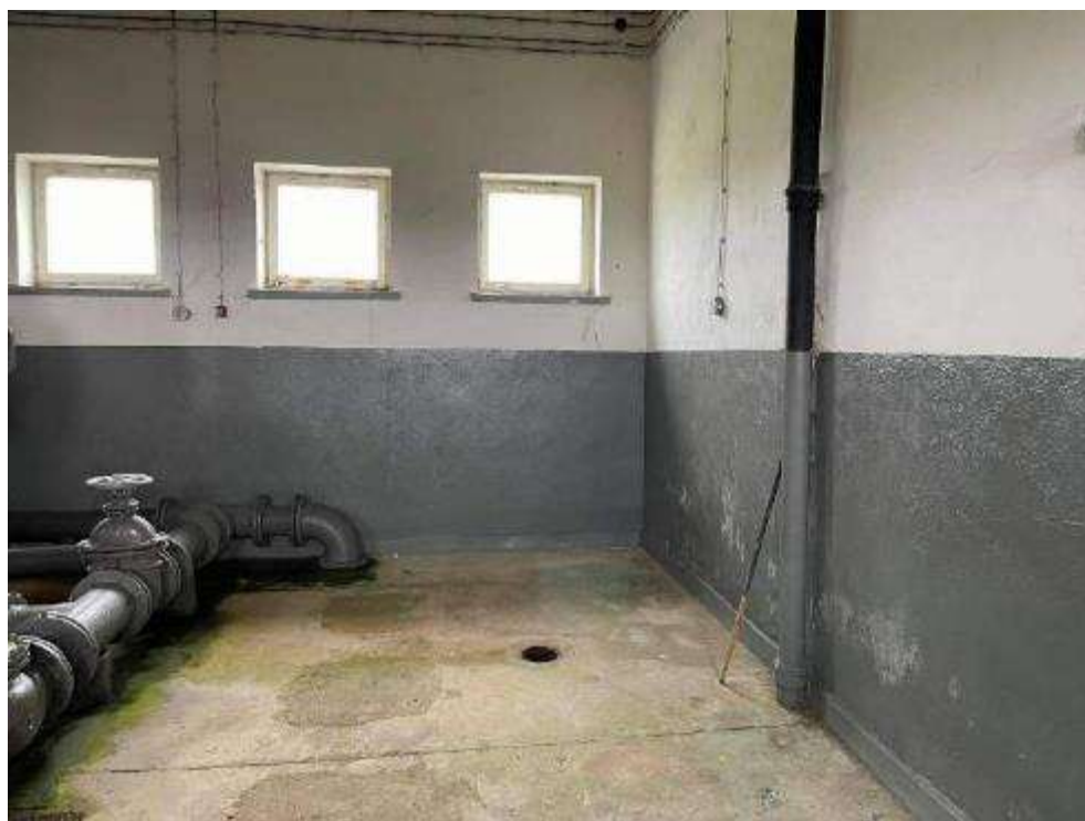
Rysunek 66. Zdjęcie wewnątrz w budynku stacji uzdatniania wody w Przebądowie.
