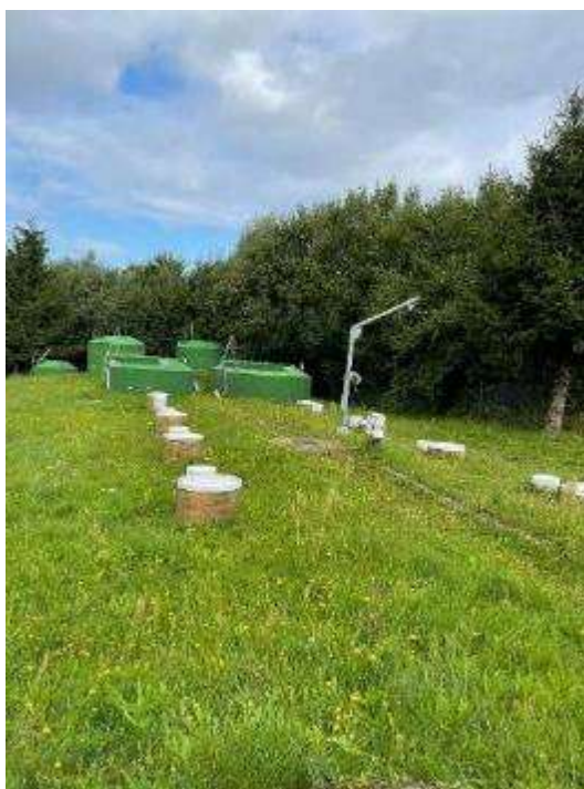
Rysunek 7. Zdjęcie ciągów technologicznych oczyszczalni.
