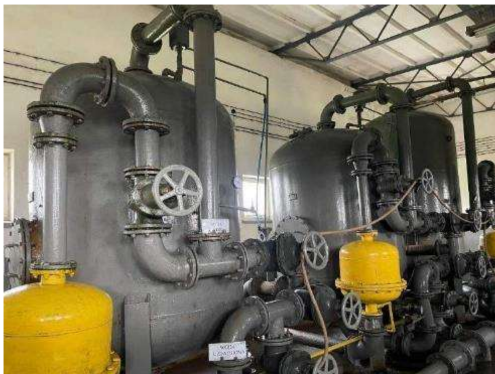
Rysunek 62. Zdjęcie zbiornika do wymiany w budynku stacji uzdatniania wody w Przebądowie.
