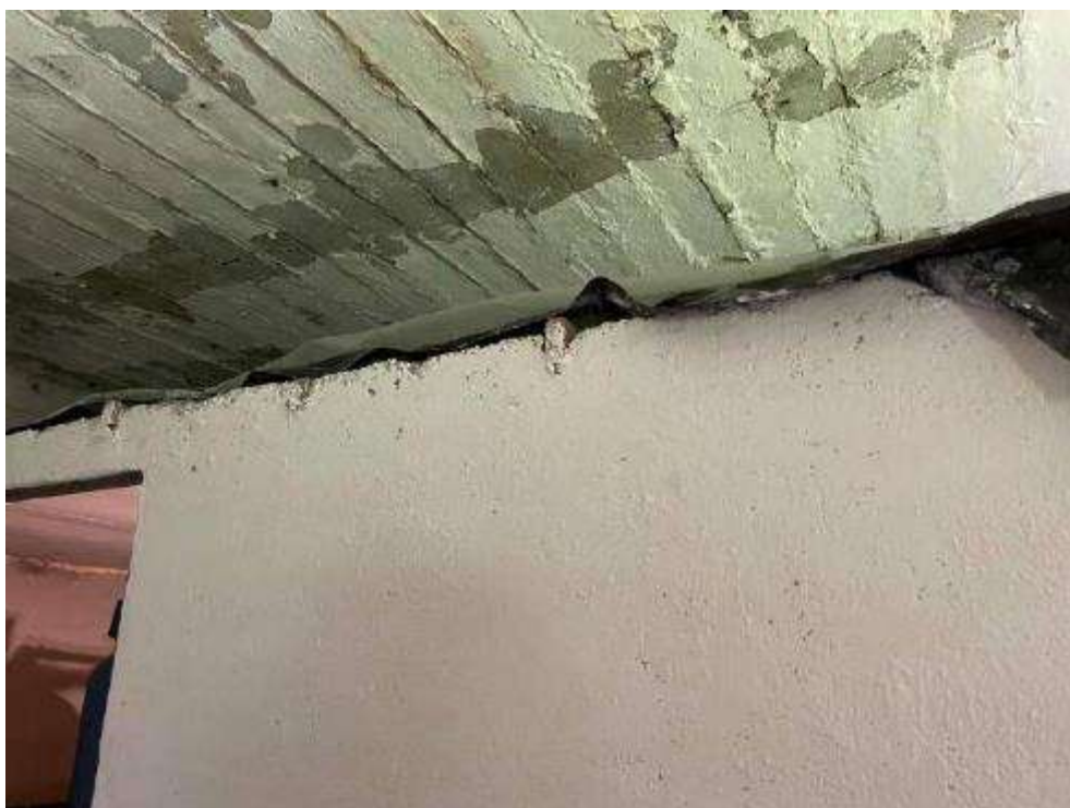
Rysunek 45. Zdjęcie budynku stacji uzdatniania wody w Jachowie wewnątrz (część, w której znajdują się urządzenia uzdatniające wodę, którą należy podnieść).
