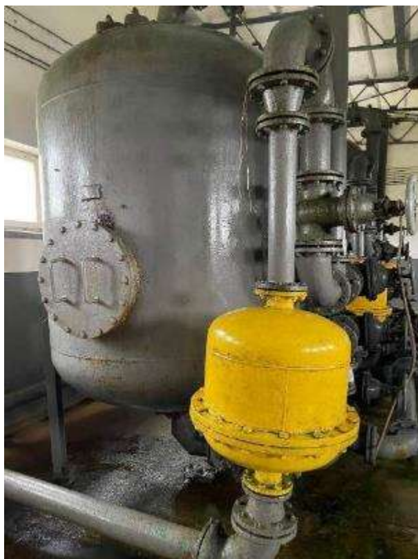
Rysunek 63. Zdjęcie zbiornika do wymiany w budynku stacji uzdatniania wody w Przebędowie.
