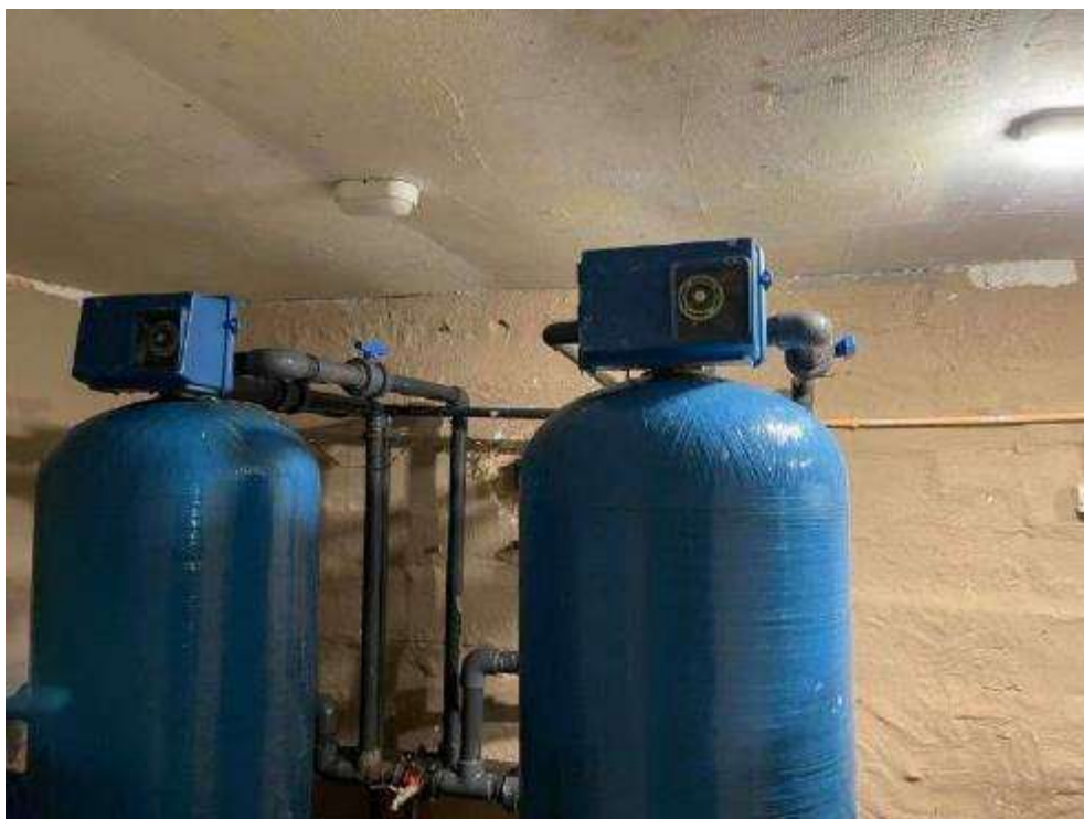
Rysunek 42. Zdjęcie budynku stacji uzdatniania wody w Jachowie wewnątrz (część, w której znajdują się urządzenia uzdatniające wodę).
