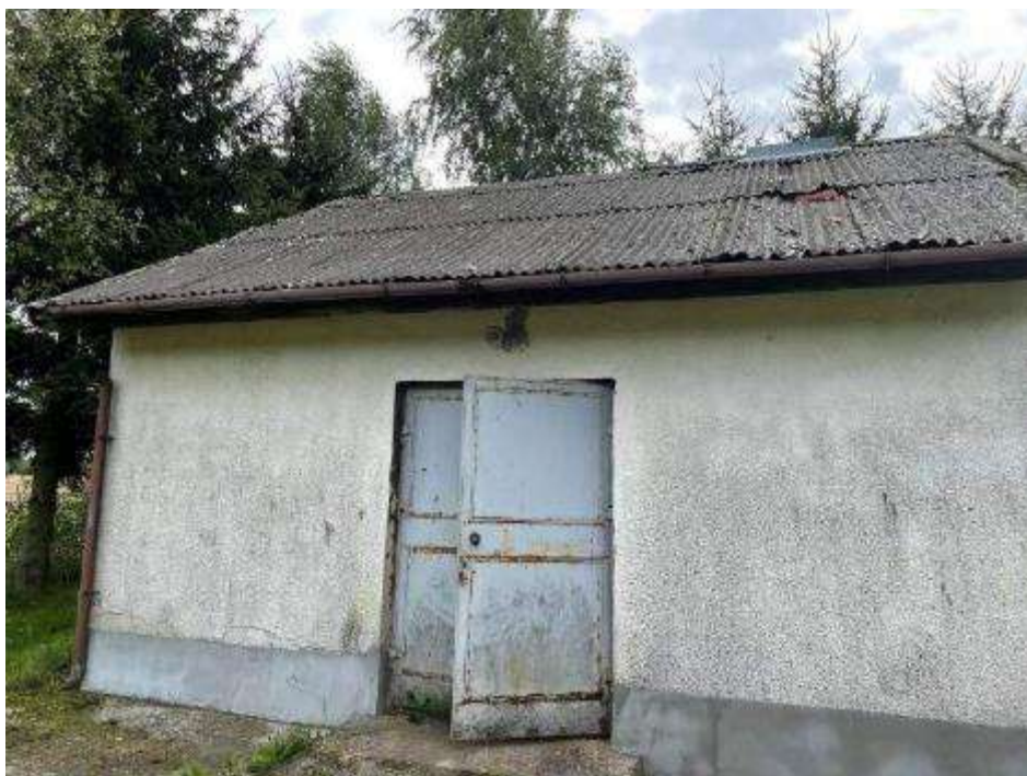
Rysunek 9. Zdjęcie budynku wraz z drzwiami dwuskrzydłowymi do wymiany.
