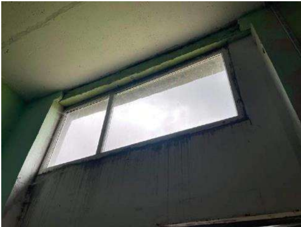
Rysunek 35. Zdjęcie budynku stacji podnoszenia ciśnienia w Lelkowie (okno do wymiany).
