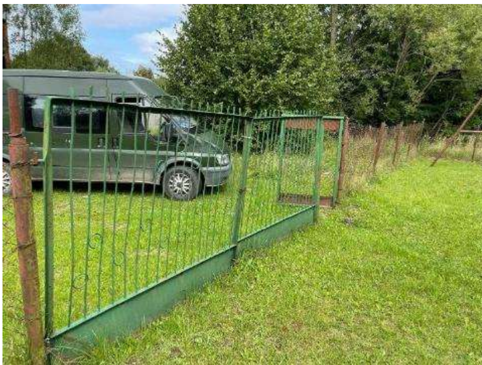
Rysunek 5. Zdjęcie- Ogrodzenie wraz z bramą przewidziane do wymiany.
