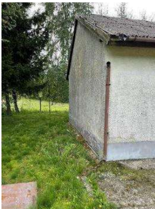
Rysunek 10. Zdjęcie budynku z orynowaniem i dachem do wymiany.
