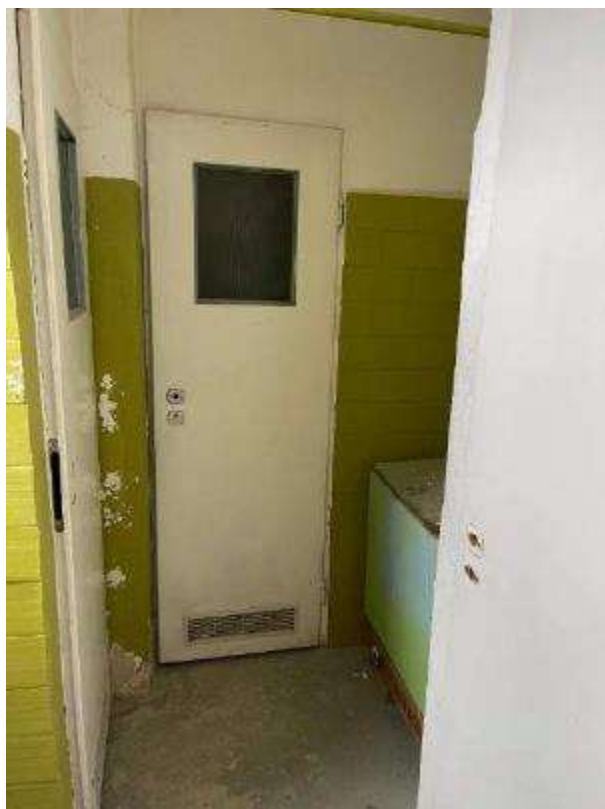
Rysunek 67. Zdjęcie drzwi do wymiany i pomieszczeń do remontu wewnątrz w budynku stacji uzdatniania wody w Przebędowie.
